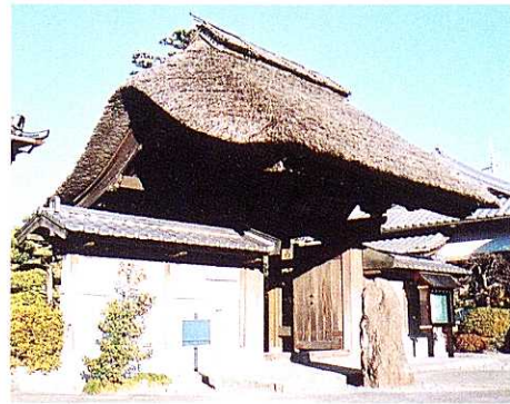
⑥永豊寺の山門（市指定） 1769年（明和6）、三ヶ名の中島重右エ門が寄進、藤枝宿木町の大工仁左衛門らにより建立されたと伝えられる茅葺葉門。1983年（昭和58）大規模な修理が行われた。（焼津市西小川）
