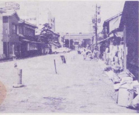
▲ 公共下水道事業のひとつとして、堀川雨水幹線の一部が約1,800万円で完成しました。将来の共用水道の使用が開始されると、この上流が改築される予定です。
